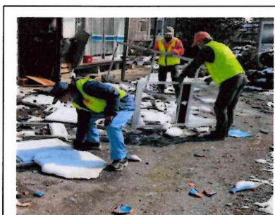
地震後、被災宅の片付け作業
